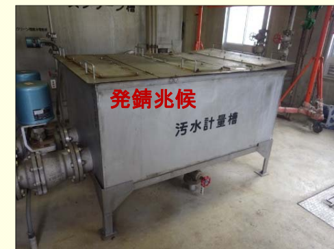
S-4: 変状兆候(軽微な変状)
