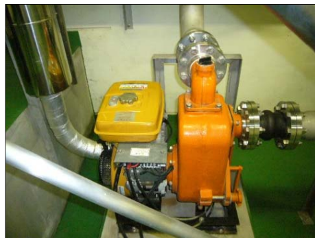
非常用エンジンポンプ
