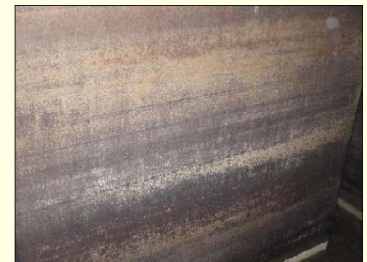
S-4: 変状兆候(軽微な変状)
