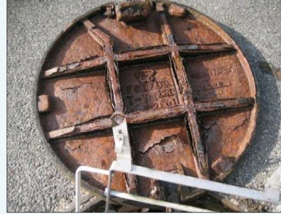
S-3: 変状あり (脆弱化顕著) 蓋裏面が全体的に腐食しており、脆弱化が顕著であるが、鋳出し表示は消滅していない
