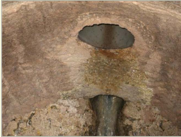
S-4: 変状兆候(表面変色、脆弱化傾向)
