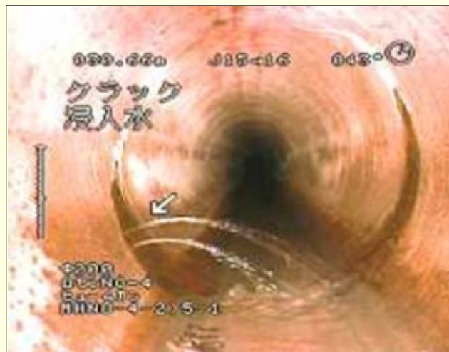
S-2: 施設の構造的安定性に影響を及ぼす変状 (管の破損による浸入水)
