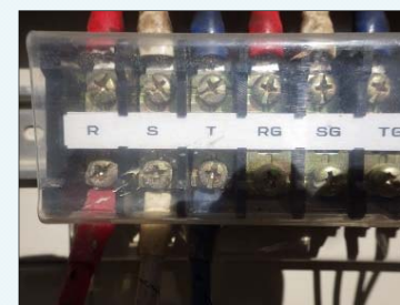
ケーブル接点劣化
