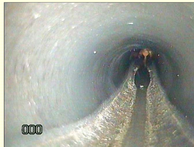
S-4: 軽微な変状 (たわみ 管内径の1/2未満)
