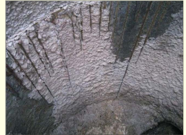
S-2: 顕著な変状あり (脆弱化: 広範囲で骨材、鉄筋が露出)
