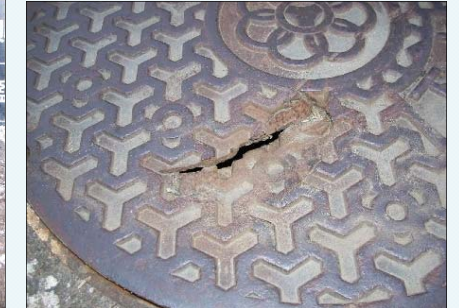
S-1: 重大な変状あり (危険な状態) 亀裂、破損
