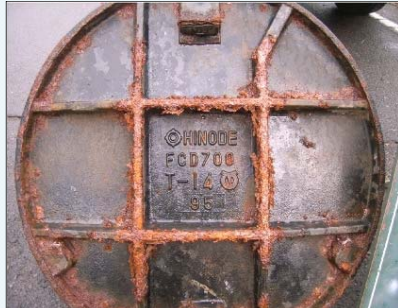
S-4: 変状兆候 (脆弱化傾向) 蓋裏面が部分的に著しく腐食しているが、それ以外は脆弱化していない
