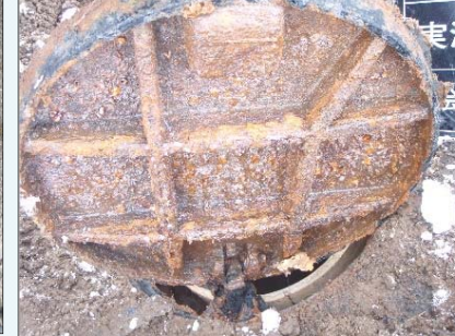
S-2: 顕著な変状あり (脆弱化) 蓋裏面が全体的に著しく腐食・脆弱化しており、鋳出し表示が消滅している
