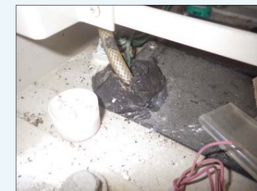
シール材劣化
