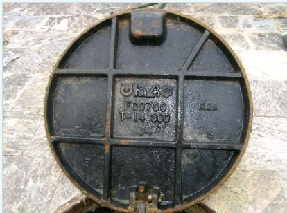
S-5: 変状なし (健全な状態) 蓋裏面が全体的に若干腐食しているが、脆弱化はしていない
