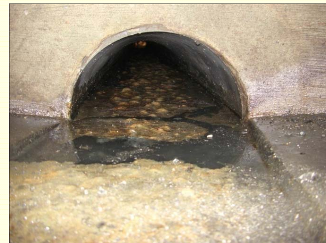
S-2: 施設の構造的安定性に影響を及ぼす変状 (インバート部汚水滞留、溢水可能性あり)
