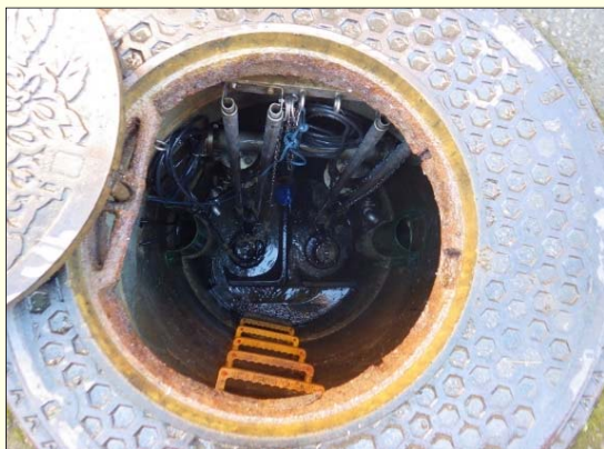
マンホール内のポンプ設備
