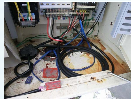
S-3: 変状あり(制御盤の劣化)
