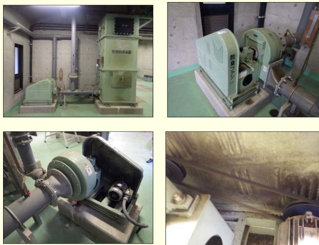
S-4: 変状兆候(軽微な変状)
