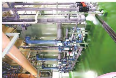
活性汚泥曝気槽
