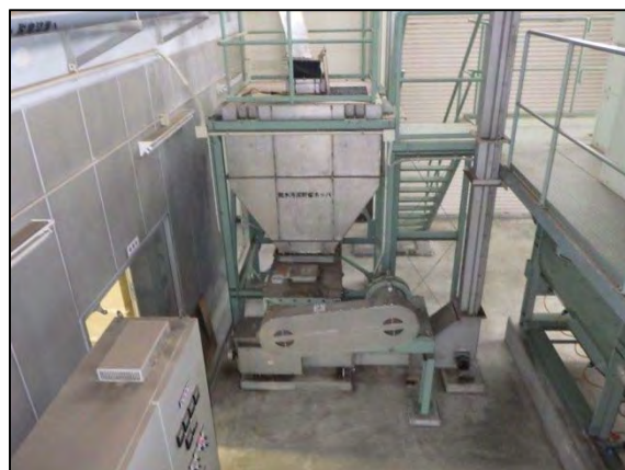
写真4 脱水汚泥貯留ホッパ
