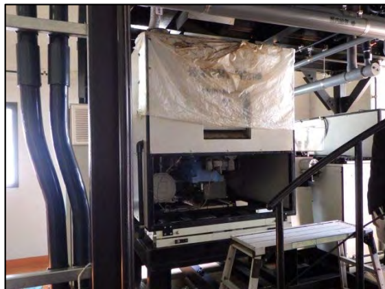
写真5 汚泥発酵装置第1槽
