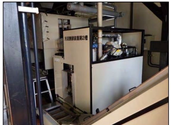
写真6 汚泥発酵装置第2槽
