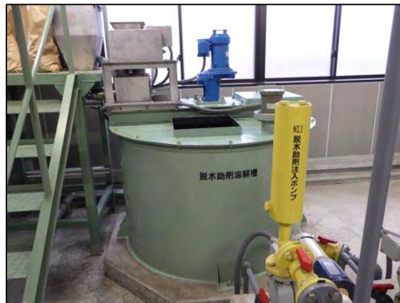
写真2 脱水助剤溶解槽
