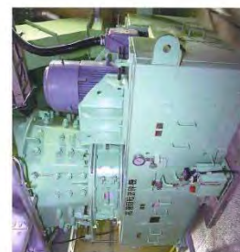
● 高速回転破砕機 二軸せん断破砕機で破砕されたごみをさらに細かく破砕します。
