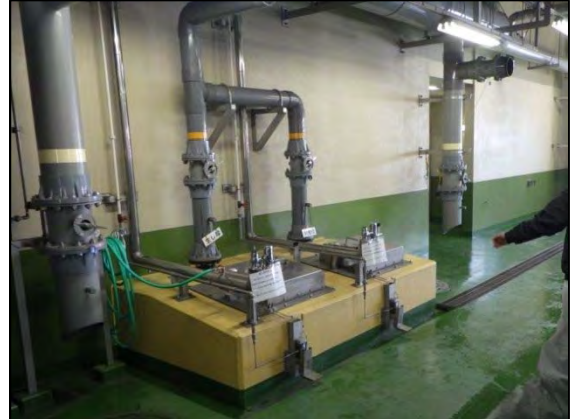
写真2 生し尿、浄化槽汚泥投入口
