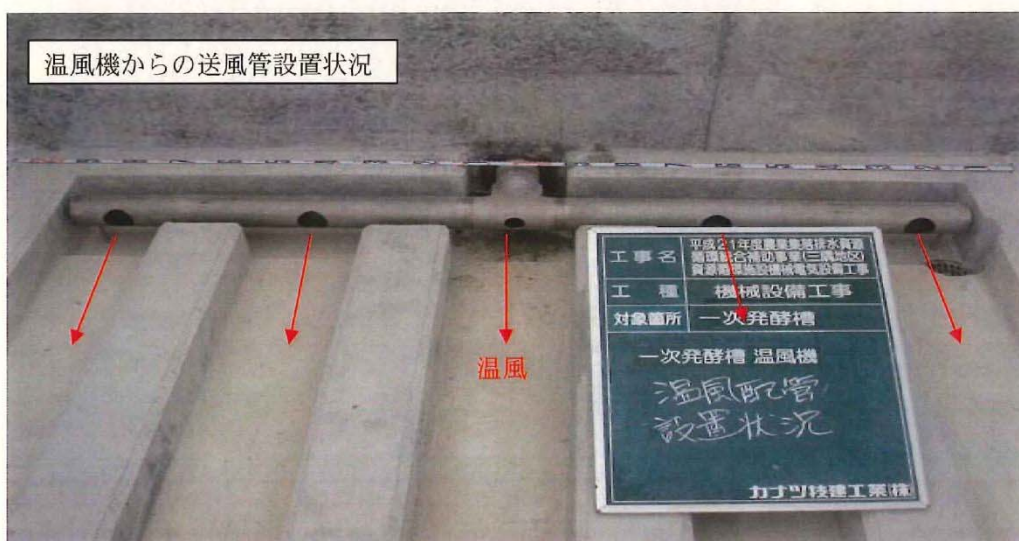
温風ユニット設置状況
