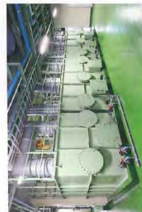
活性炭脱臭塔
