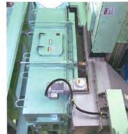
● 磁選機 破砕ごみの中から磁石の力を利用して鉄を回収します。
