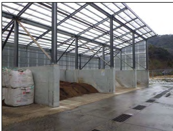
写真7 乾燥槽、ストックヤード
