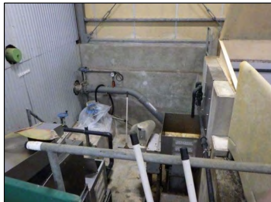
写真 2 原料投入室内部
