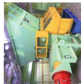
● 二軸せん断破砕機 二軸せん断破砕機供給コンベヤから供給されたごみを粗破砕します。
