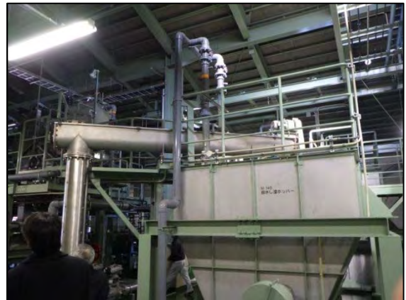
写真4 脱水し渣ホッパー
