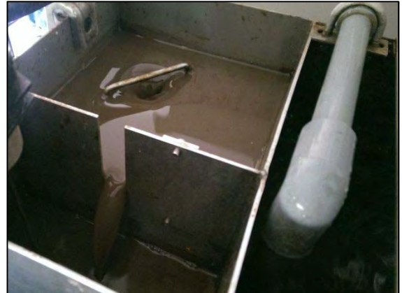
写真2 汚泥量調整槽
