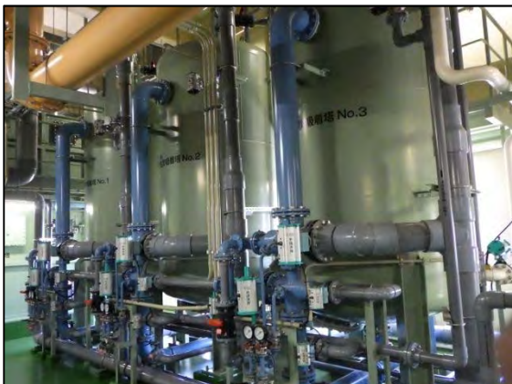
写真7 活性炭吸着塔
