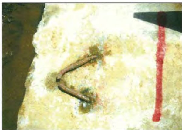
写真2 写真13のFRP製処理槽の浮上防止 アンカーの破断状況（鉄筋の腐食あり） 【H23年東北地方太平洋沖地震】
