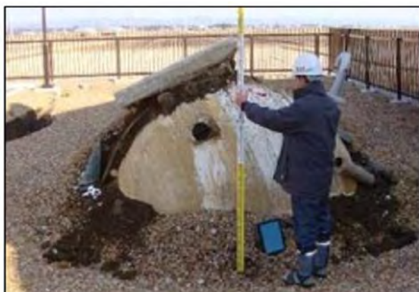
写真1 地震動によるFRP製処理槽の破損 【H23年東北地方太平洋沖地震】
