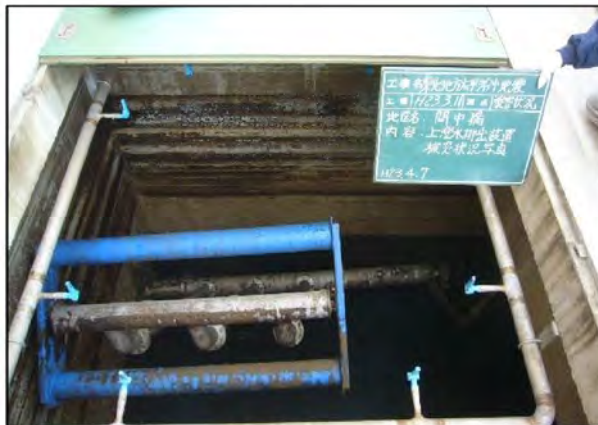
写真8 地震動による上澄水排出装置（機械式）の破損《応急復旧》 【H23年東北地方太平洋沖地震】
