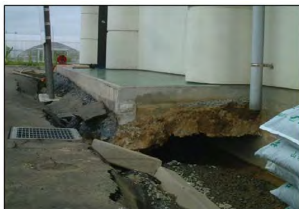
写真4 地震動（液状化）による外構資材 （縁石等）の破損 【H15年宮城県北部地震】
