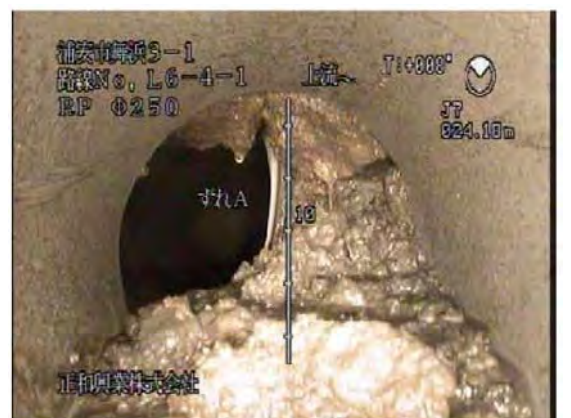
写真30 接合部ずれ、噴砂侵入 【H23年東北地方太平洋沖地震】
