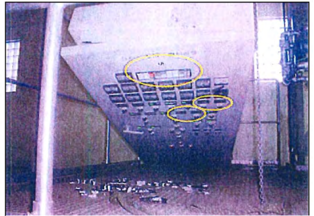
写真10 地震動による脱水機制御盤の転倒 【H23年東北地方太平洋沖地震】
