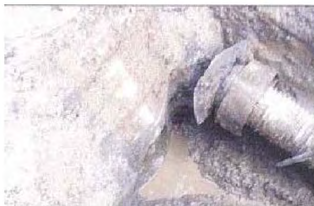
写真27 マンホール継手の剥がれ 【H23年東北地方太平洋沖地震】
