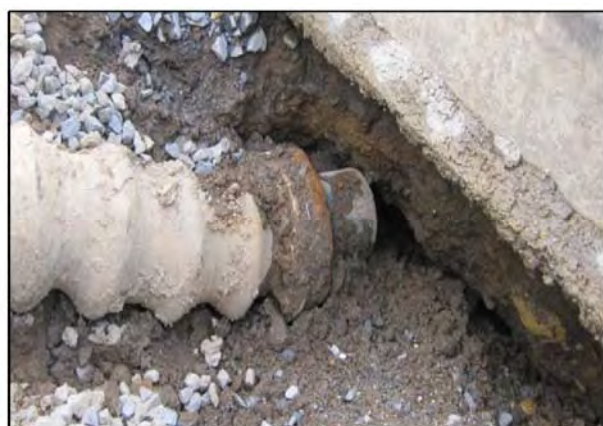
写真3 地震動（液状化）による流入管等の破損 【H23年東北地方太平洋沖地震】
