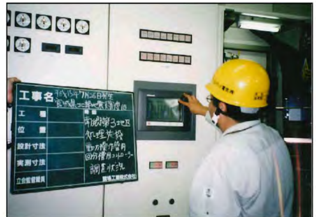
写真11 地震動による制御盤内コントローラの破損 【H15年宮城県北部地震】
