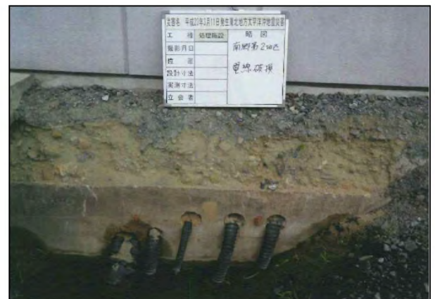
写真12 地震動による引込設備（電線管、ケーブル等）の破損 【H23年東北地方太平洋沖地震】
