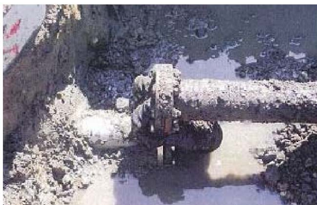
写真26 本管軸方向移動による上下のずれ 【H23年東北地方太平洋沖地震】
