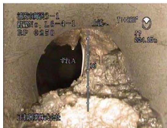
写真30 接合部ずれ、噴砂侵入 【H23年東北地方太平洋沖地震】
