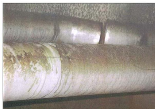
写真6 地震動による配管類の破損 【H23年東北地方太平洋沖地震】
