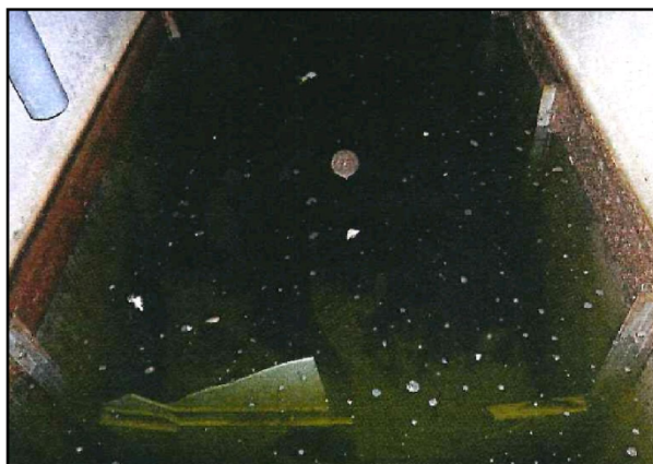
写真9 地震動による消毒槽PVC製迂流板の破損 【H19年新潟県中越沖地震】
