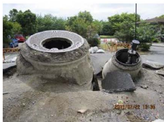
写真29 非常貯水槽マンホールの浮上 【H23年東北地方太平洋沖地震】
