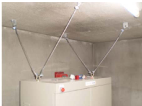
写真 4 2 制御盤の転倒防止 【制御盤の頂部支持】※8
