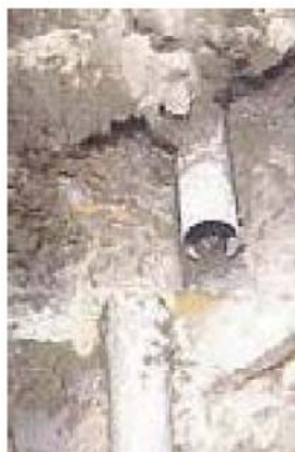
写真25 SRA本管抜け+ずれ 【H23年東北地方太平洋沖地震】
