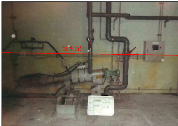
写真7 流入水等による地下水水没に伴う自動荒目スクリーン等の故障 【H23年東北地方太平洋沖地震】
