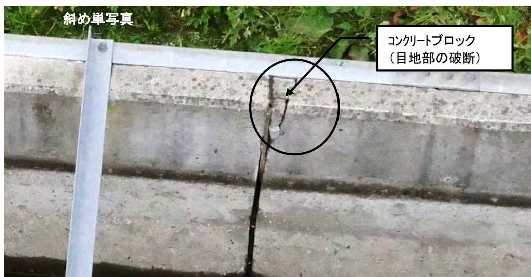
図7.14 目地部の損傷（破断）の検出例
