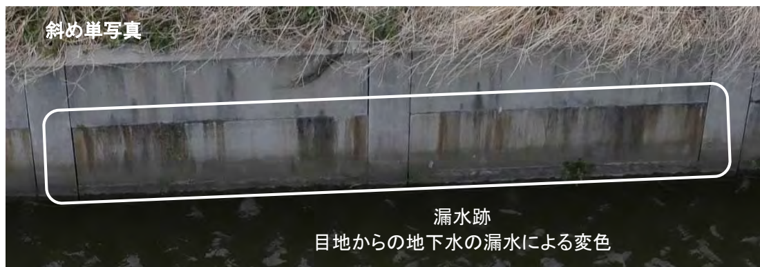
図7.24 地の劣化による漏水の痕跡
