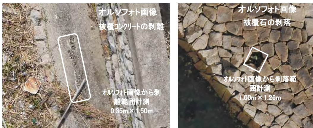
図7.4 剥離・剥落の検出例
