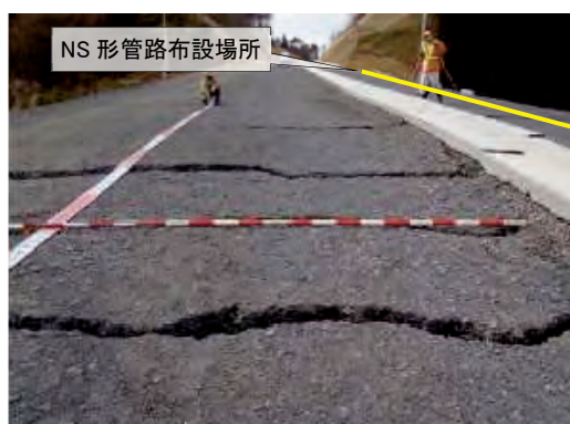
写真 2.1 横断亀裂 測点 1230m
