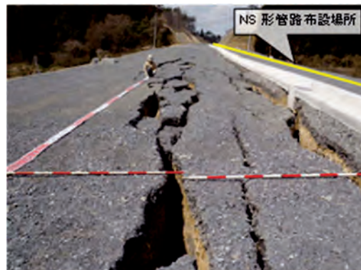
写真 2.2 縦断亀裂 測点 1260m
