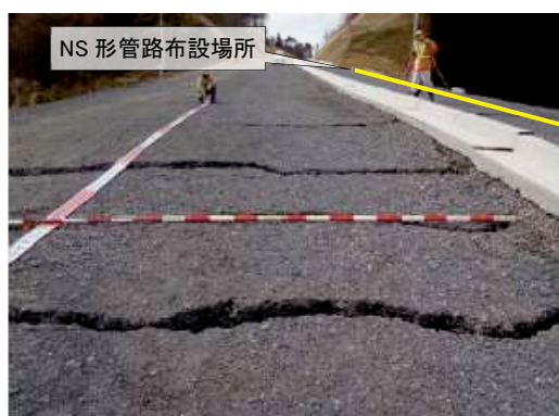
写真 2.1 横断亀裂 測点 1230m
