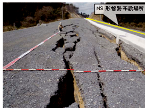
写真 2.2 縦断亀裂 測点 1260m
