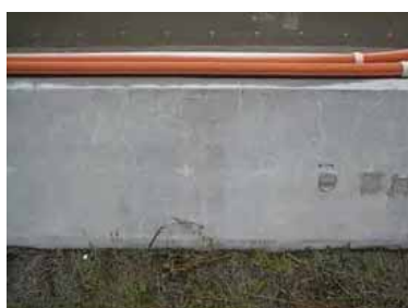
開水路で発生した無機系被覆材のひび割れ
