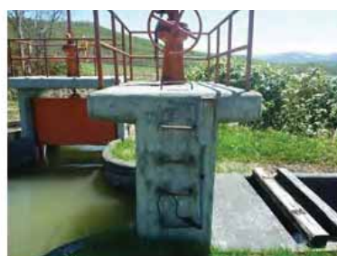
ゲート施設で発生した無機系被覆材のひび割れ
