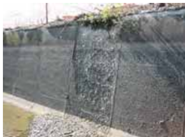
断面欠損を生じた開水路の側壁
