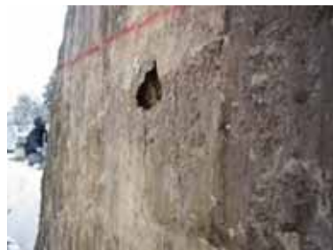
浮き・剥離を生じた頭首工の堰柱
