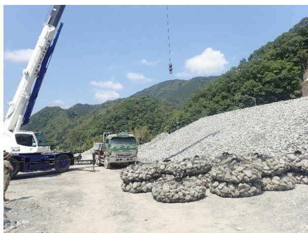
設置前ヤード全体写真
