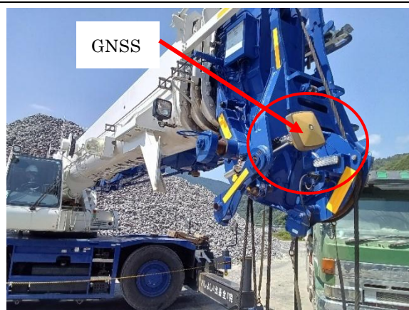
図 23 GNSS 受信機取り付け状況
