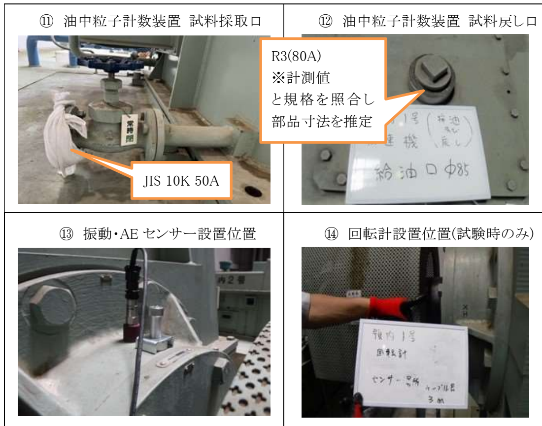
図 1-7 センサーの設置、ケーブル長、油配管寸法と長さの確認(減速機)
