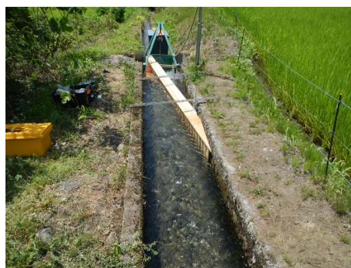
除塵機設置後
