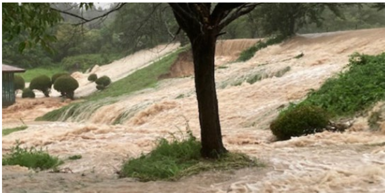
写真-2 2022年8月 福島・山形・新潟豪雨災害によるため池の越水状況 ため池の越水状況(撮影:山形県川西町)
