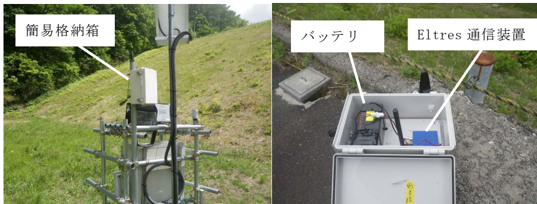
観測ヤグラへの取付け状況
