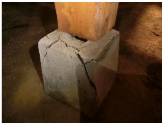
写真 1. 6－15 硫酸塩による住宅基礎束柱の膨張破壊 18)
