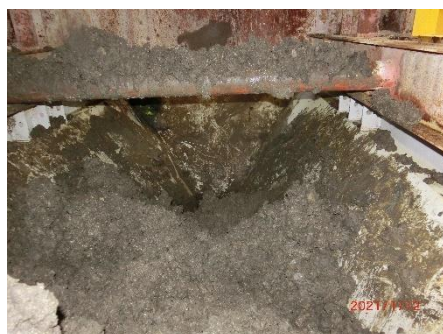
(23) 土砂供給装置 ホッパー内部
