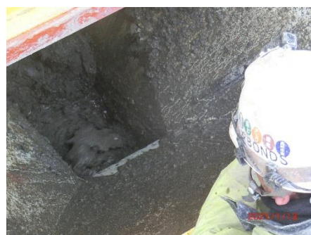
(24) 土砂供給装置 ホッパー内部
