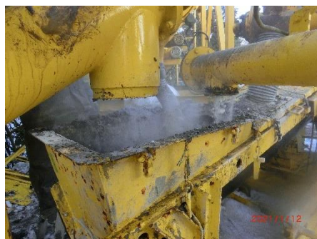
(25) 原泥・改質材供給 (撮影のためカバー取り外し)
