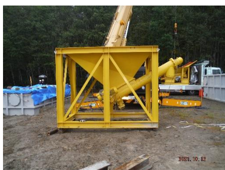
(21) 泥土供給装置
