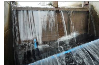
写真-7 傾斜板の流
