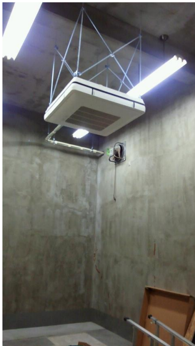
図 2.1 恒温室内の状況
