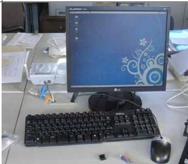
施設管理サーバ外観
