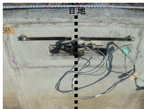
写真-12 9 ヶ月経過後の目地部表面
