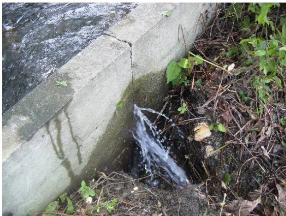
写真－1 目地部からの漏水
