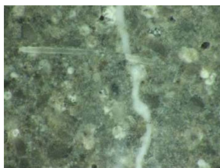
写真－４ ECC ひび割れ部の目詰まり状況
