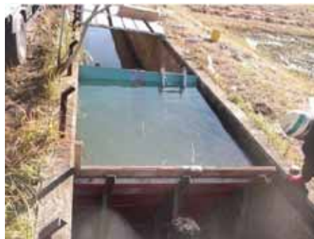
図-2.1.2 区間締切装置設置状況
