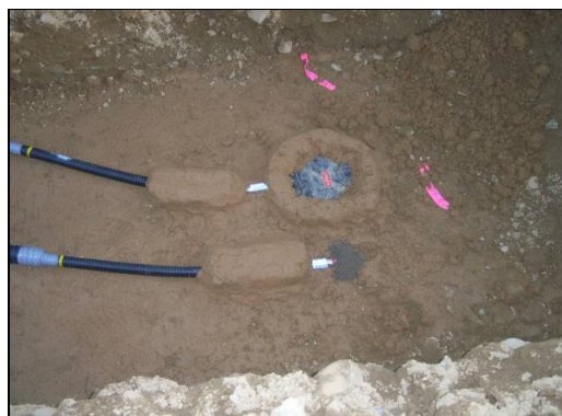
⑥設置例-3 胆沢ダム(土・水圧併設)
