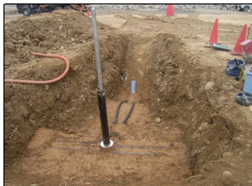
⑧設置例-5 胆沢ダム(層別沈下計)
