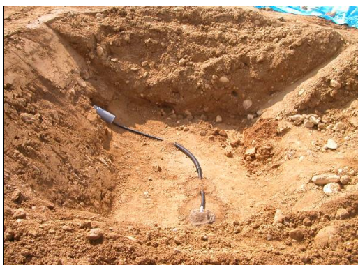
⑤設置例-2 胆沢ダム(間隙水圧計)
