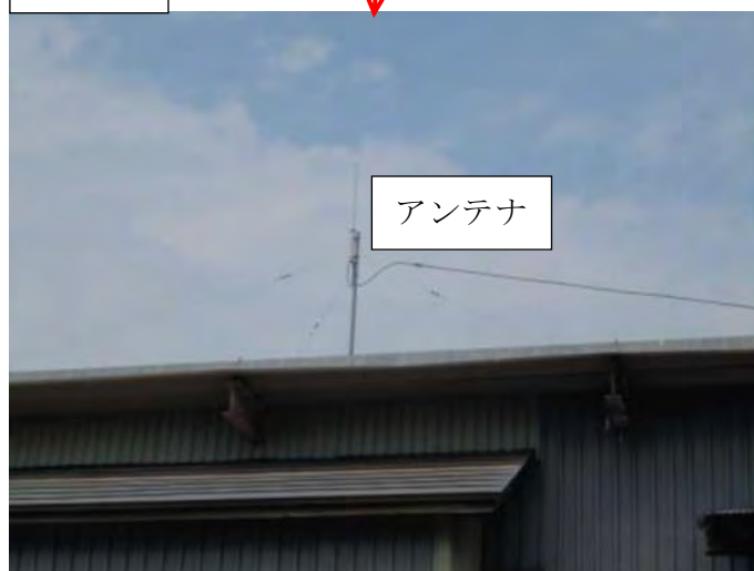
写真 1.7.3 ゲートウェイ設置状況 (無線通信距離確認)
