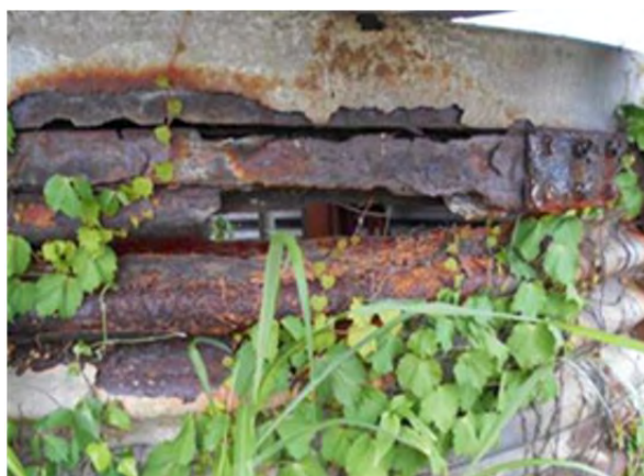
図 9-3 本体の状況 外部の腐食（丸山 7 号）
