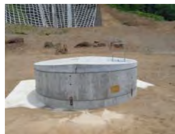
鉄筋コンクリート製集水井
