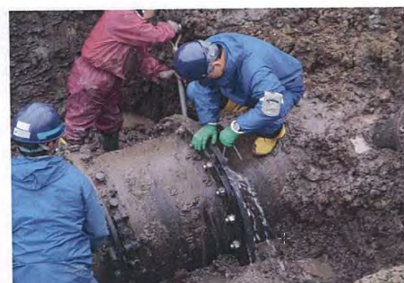
図-1.2 構造物近傍での漏水 (北海土地改良区内)
