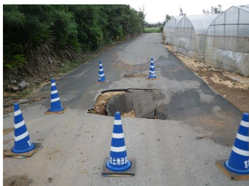
図 1 支線パイプラインの破損事故現場状況
