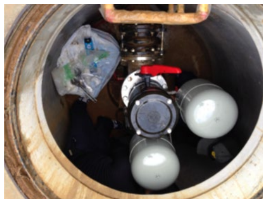
図 23 宮古島地区圧力変動緩和装置の設置例
