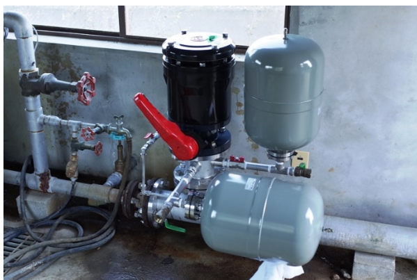
図 22 多良岳地区圧力変動緩和装置の設置例
