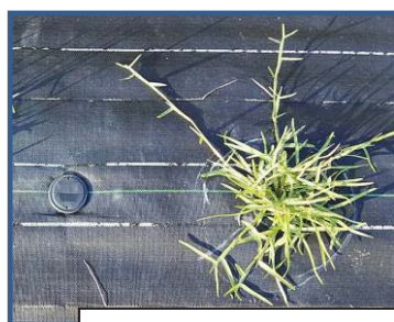
シート設置から約 10 か月経過後の PP 耐候剤抜きヤーンの状態
