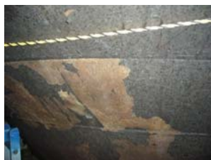
ケーシング上部の 塗装剥離
