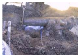
漏水事故が頻発
