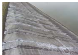
遮水シート劣化
