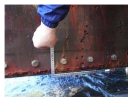
ゲートの塗装劣化
