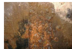
鋼管内面腐食
