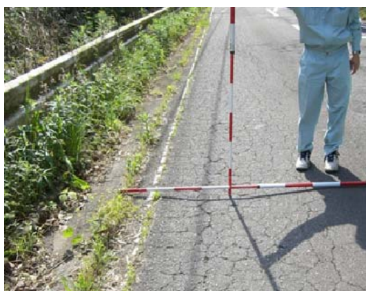
舗装路面のひび割れ・沈下状況
