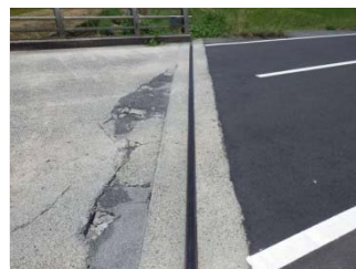
伸縮装置 (舗装一部破損)
