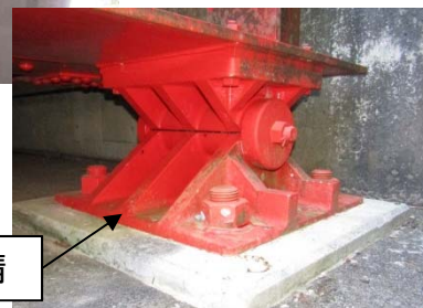
塗装剥離及び浮錆
