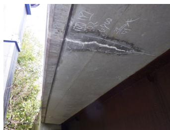
床版ひび割れ
