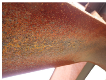
アーチ部横支材の腐食
