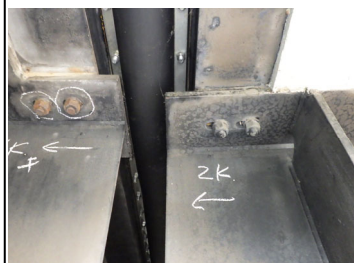
補鋼材ボルトの腐食
