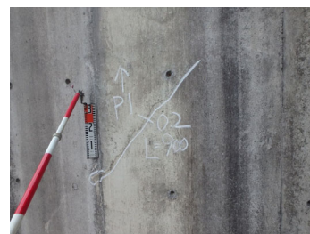
P1橋脚ひび割れ
