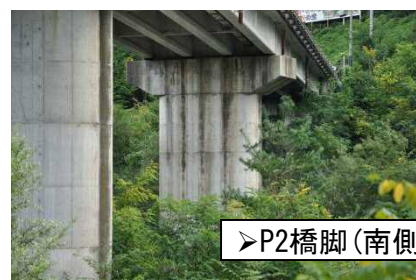
➤錆び汁を伴うひび割れ
