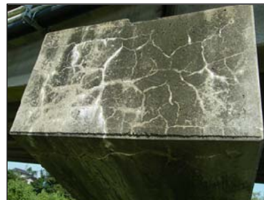
下部工損傷状況
