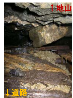
覆工背面空洞
