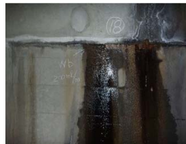
水平打継ぎ目からの漏水
