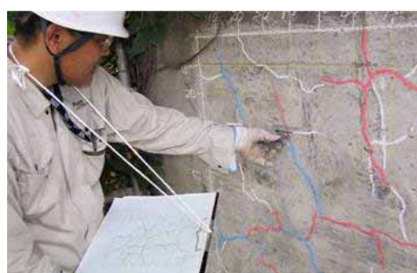
ひび割れ確認
