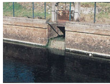
宮田導水路 (雑排水流入)
