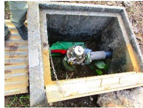
整備された給水栓
