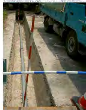
農業用水路（パイライン）
