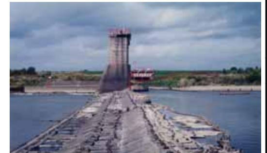
(旧)石狩川頭首工の劣化状況
