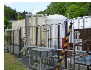
写真9 ガス発電設備 （防災機能の強化）
