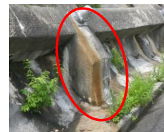
図3.7: 地下水が湧出している
