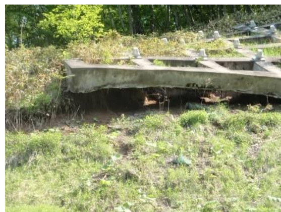
「地表の沈下」 (滑落崖の形成)
