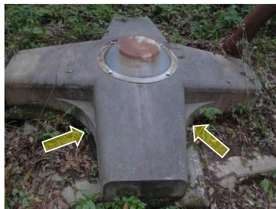
「浮き上がり」 （背面土砂流亡）
