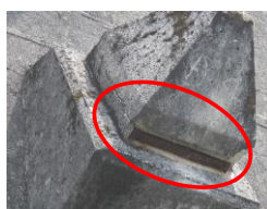
図3.5: プレートの錆
