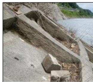
図1.4: 頭部コンクリートが落ちている
