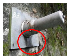
図3.3: 頭部キャップからの油脂漏れ
