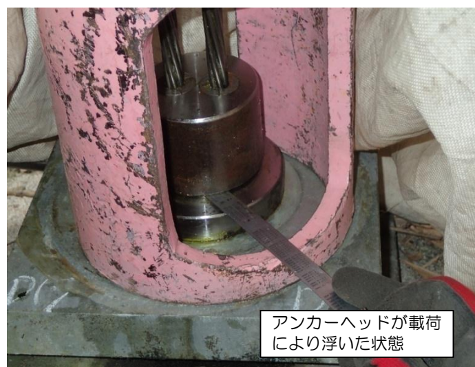
図 3-33 リフトオフ状況（定着具の変位）
