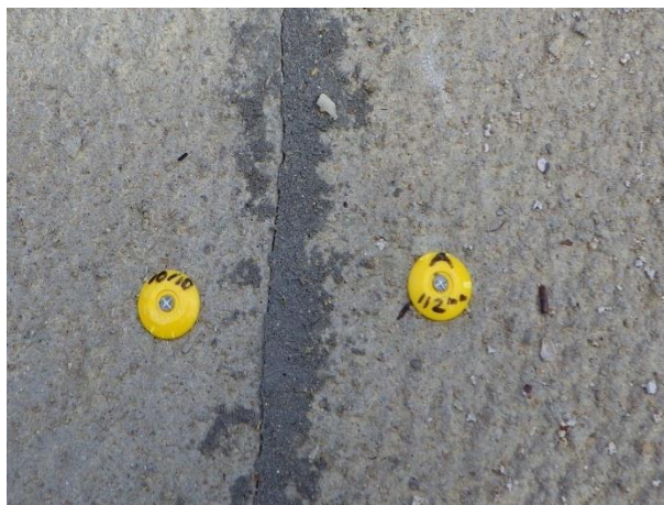
図 3-25 測量鋺による計測地点の設定（吹付工のひび割れ幅監視例）
