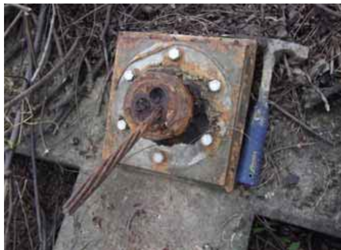
図 2-4 テンドンの腐食事例
