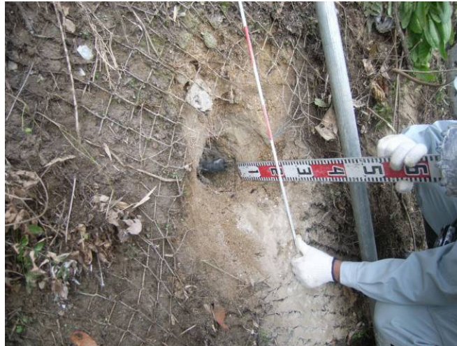
図 2-8 受圧構造物落下箇所状況
