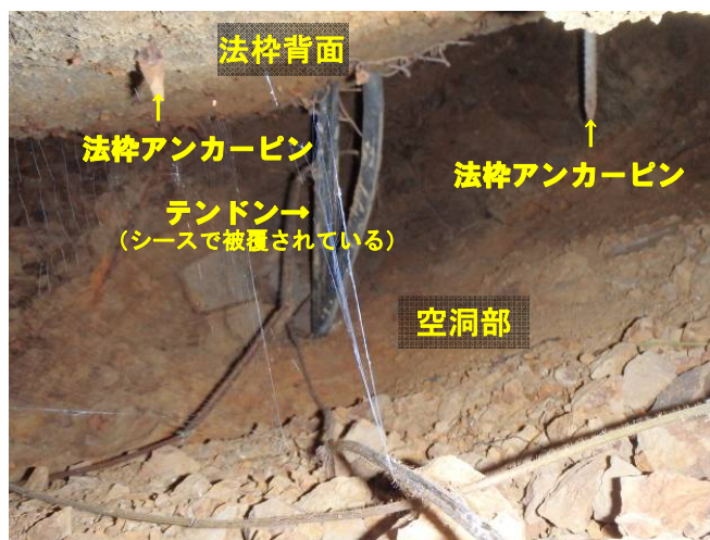
図 2-2 吹付法枠工背面の空洞部
