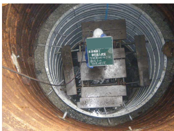
パイプ類接続状況
