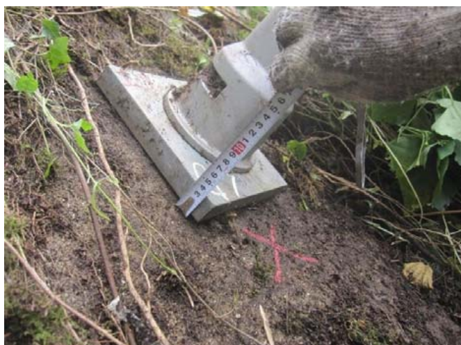
図 2-16 頭部・プレートの浮きの事例
