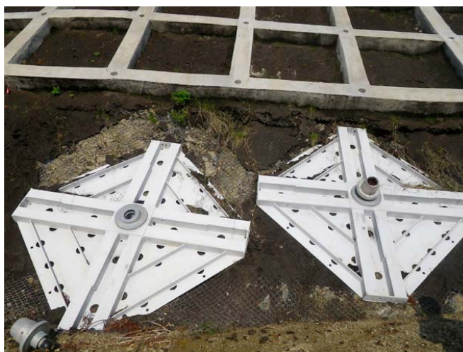
図 2-20 受圧構造物の大きな変状の事例
