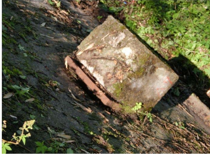
図 2-5 頭部コンクリートの浮き事例
