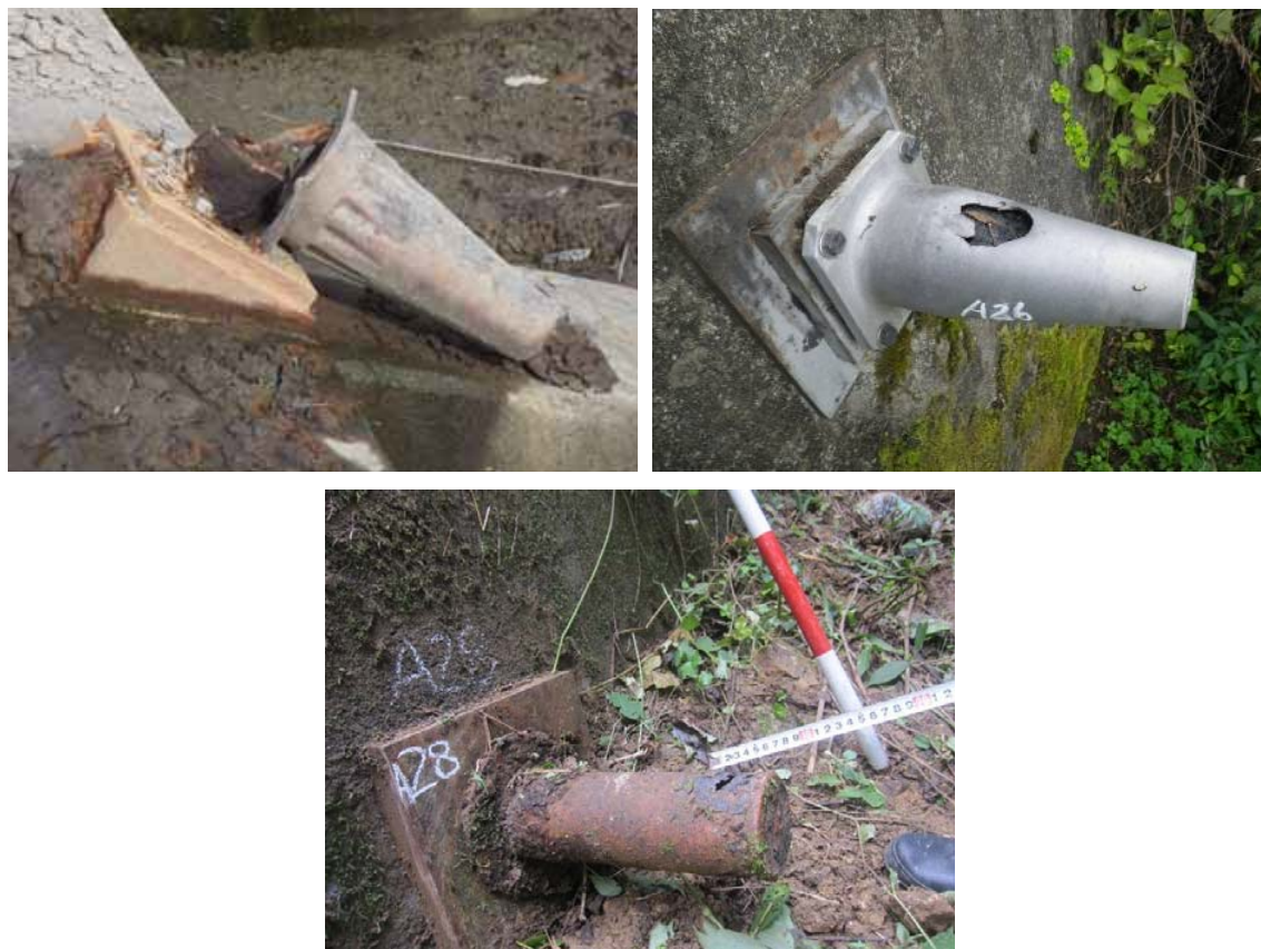
図 2-11 頭部キャップの損傷の事例
