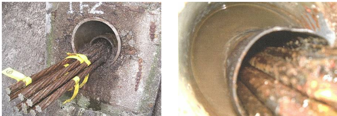
図 2-27 頭部背面の異物等混入の事例
