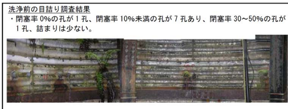
図2.1.2 (3) 洗浄前の集水ボーリングの目詰まり状況
