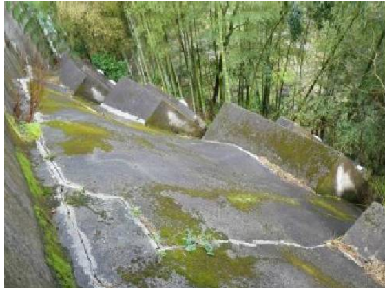
アンカー周辺の吹付工の変状
