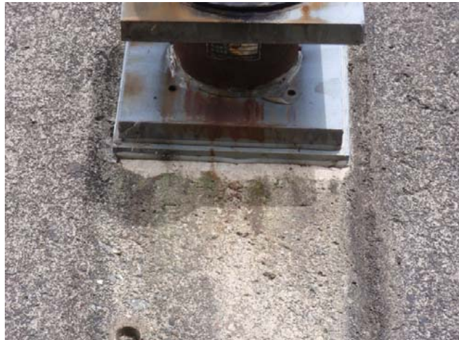
図 2-17 プレート背面からの漏水の事例
