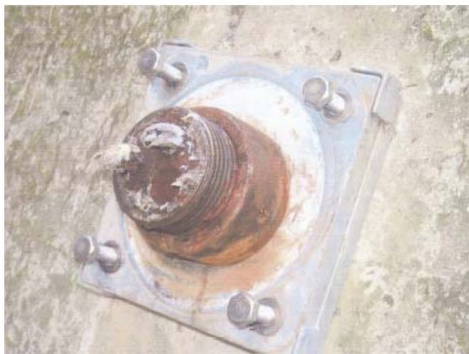
図 2-23 定着具の腐食の事例
