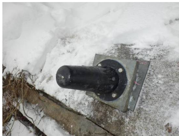
図 2-1 対象箇所に設置されたアンカー
