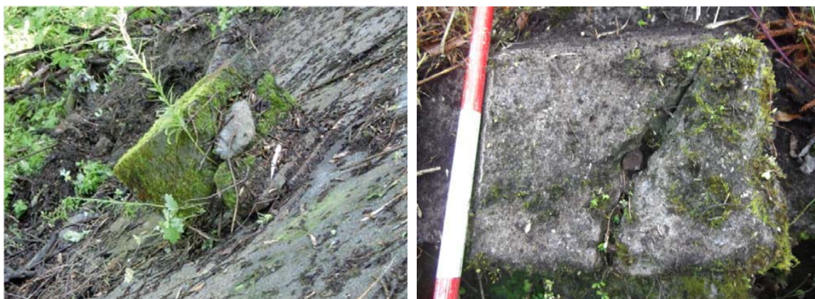
図 2-7 破壊・部分的な欠損の事例
