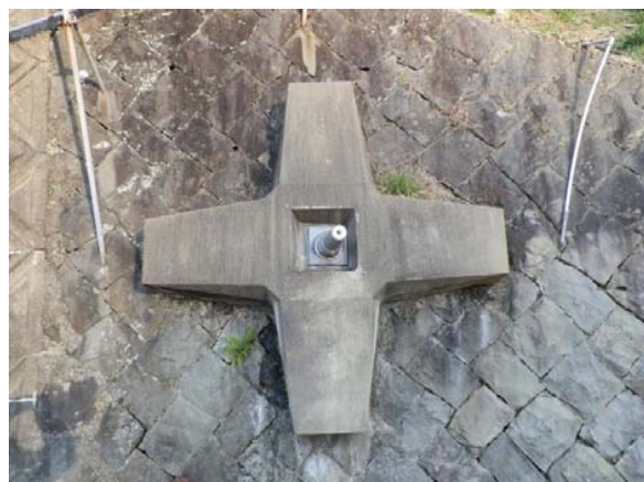
独立受圧板（コンクリート製）
