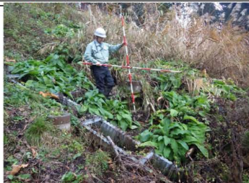
②杭の浮き上がり(30cm)、水路の両脇の侵食
