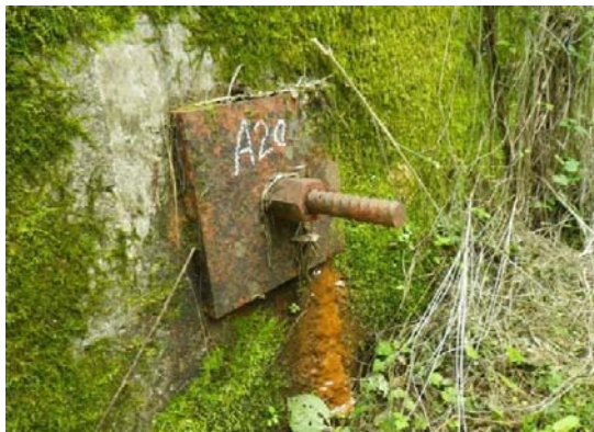
図XI-2.2.4 頭部保護がない場合のテンドンの腐食事例
