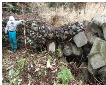
図VI-2.2.1 堆砂高さの減少の例(堰堤工袖部付近で上流側に向かって撮影)
