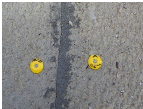
図XI-2.2.6 測量鉋による計測地点の設定（吹付工のひび割れ幅監視例）
