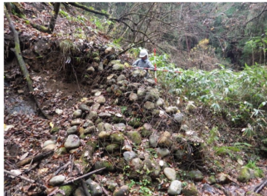
①石積堰堤の崩壊
