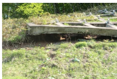
「地表の沈下」(滑落崖の形成)
