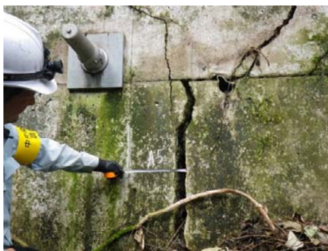
図XI-2.2.8 受圧構造物に生じたひび割れ、段差等を伴うひび割れの事例
