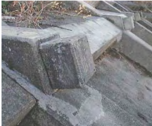
①頭部コンクリート この状態で容易に頭部露出することは不可能。
