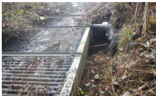
図Ⅰ-3.5.1 水路基礎地盤の洗掘によって水路が不安定化しつつある例
