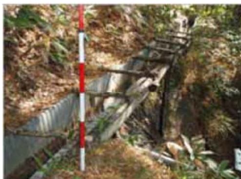
図Ⅱ- 2.2.1 施設機能に影響のある施設周辺地盤状況の例 (水路基礎地盤の侵食・崩落により水路が破断・落下する危険性があるもの)
