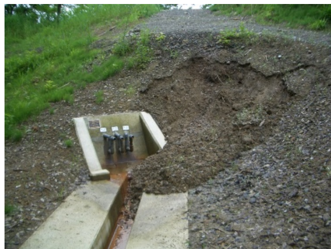
図Ⅲ-2.2.4 施設機能に影響のある施設周辺地盤状況の例 (背後斜面の崩落、崩土による集水升および流末処理施設の埋没)
