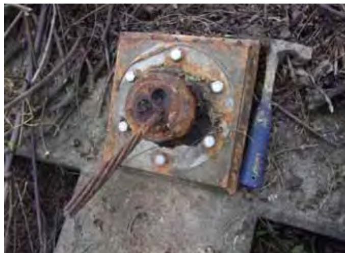
図 2-4 テンドンの腐食事例
