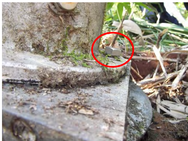
図 2-13 固定ボルトの緩みの事例
