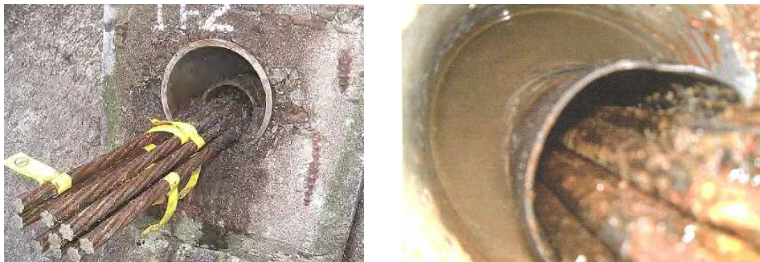
図 2-27 頭部背面の異物等混入の事例
