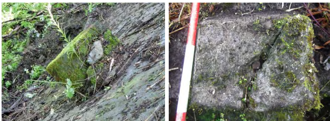
図 2-7 破壊・部分的な欠損の事例
