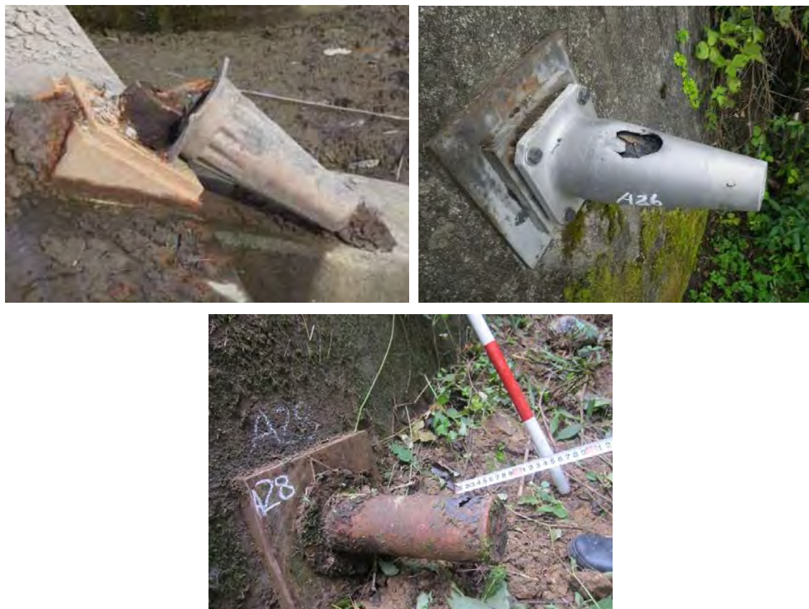
図 2-11 頭部キャップの損傷の事例
