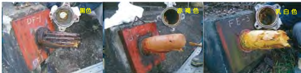
図 2-22 防錆油の劣化の事例
