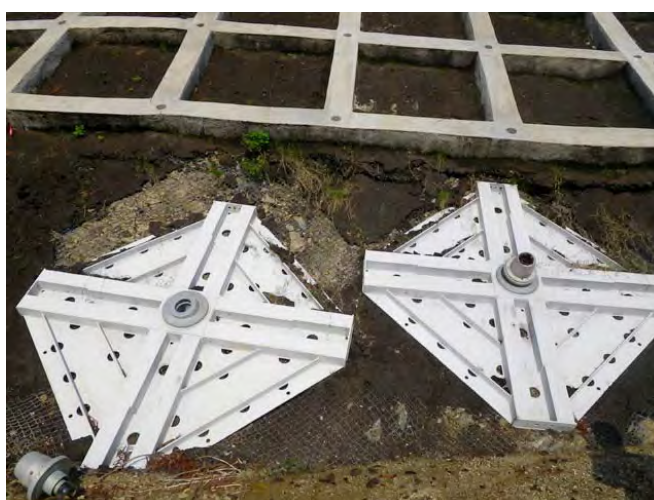
図 2-20 受圧構造物の大きな変状の事例
