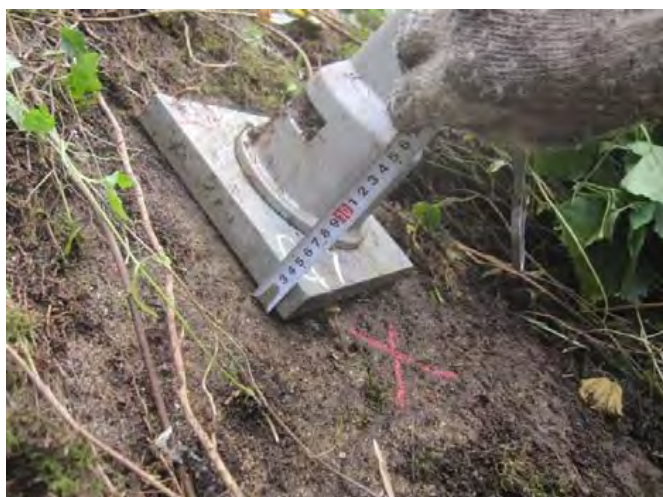
図 2-16 頭部・プレートの浮きの事例
