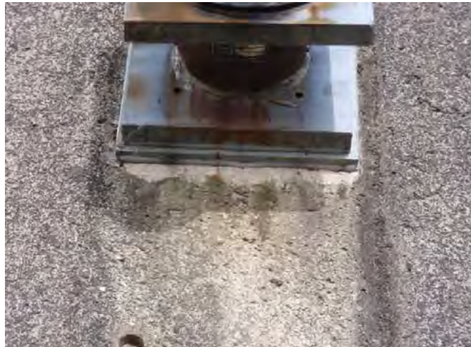
図 2-17 プレート背面からの漏水の事例
