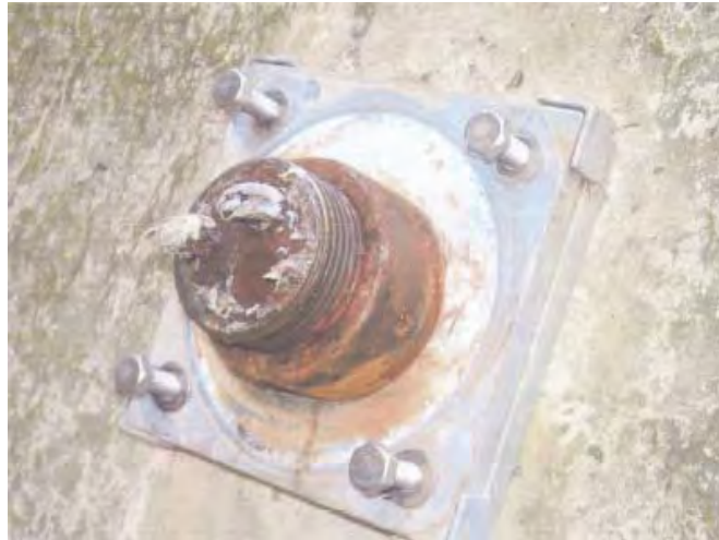
図 2-23 定着具の腐食の事例
