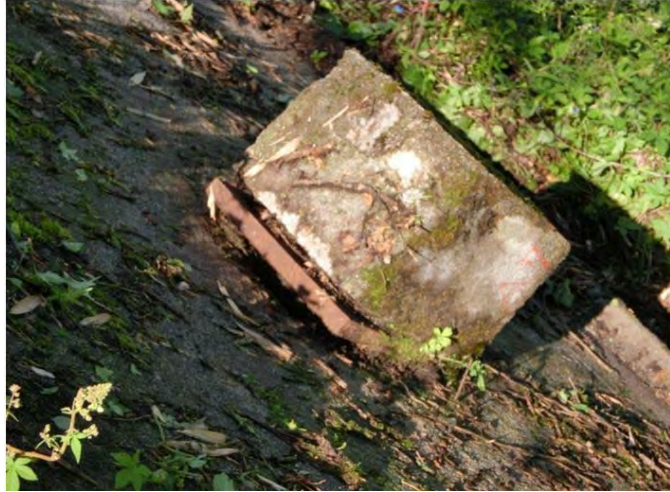
図 2-5 頭部コンクリートの浮き事例
