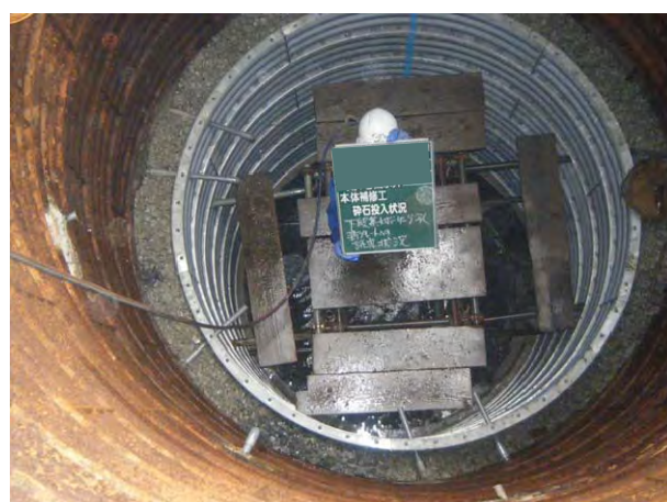
パイプ類接続状況
