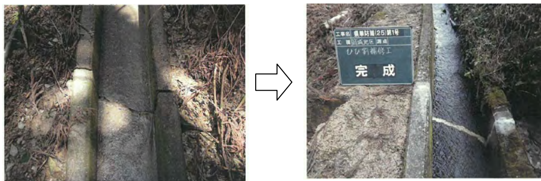
図-1.1 水路工のひび割れ補修
